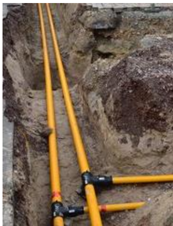
Die Ringleitung mit Hausanschluss
